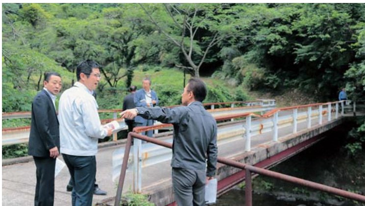
老朽化した坂下橋(川内地区)
