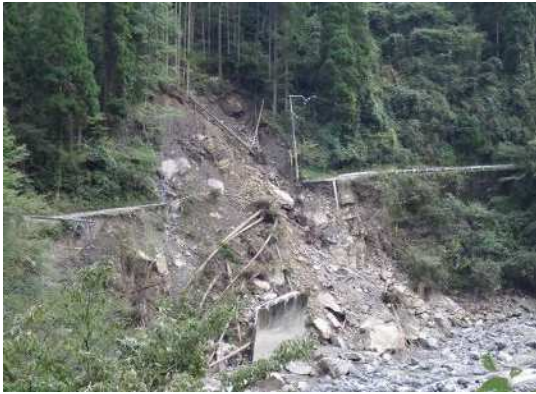
① 令和4年の台風14号時、球磨川上流域の山腹崩壊により、村道とライフラインの寸断、河川への流れ込みが発生 (撮影:令和4年9月20日)
