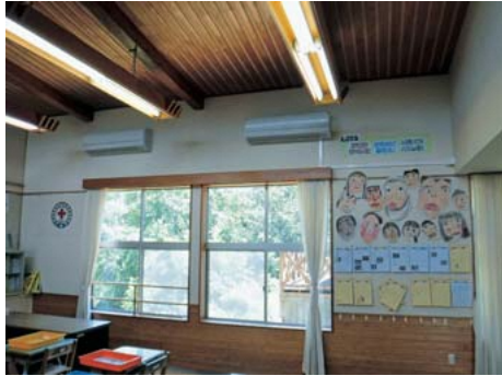
湯山小・空調設備
