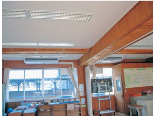
岩野小・空調設備
